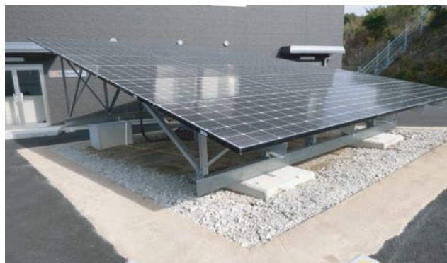
実物大太陽光パネル（施設前設置）
